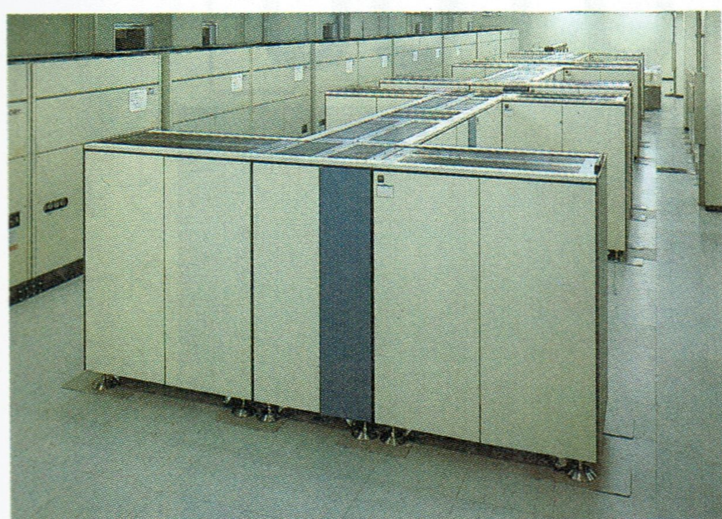
ホスト・コンピュータルームの様子。『PC-VAN』の膨大なデータが蓄積されている。
